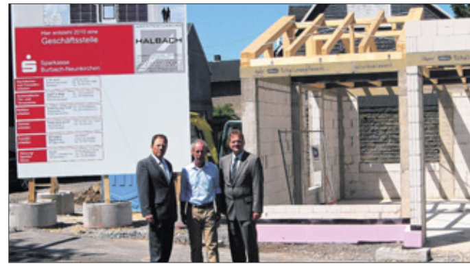
Freuen sich auf die Fertigstellung des Sparkassen-Neubaus in Struthütten (v. l.): Wolfgang Franz, Vorstandsvorsitzender der Sparkasse, Hans-Werner Feuring vom Architekturbüro Halbach und Sparkassen-Vorstandsmitglied Frank Podehl.
