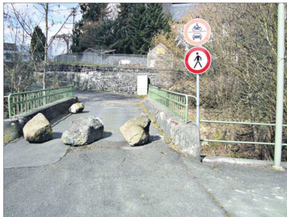
Noch ist sie gesperrt, aber bald für den Verkehr wieder geöffnet: Die Brücke Kirchweg in Niederdresselndorf
